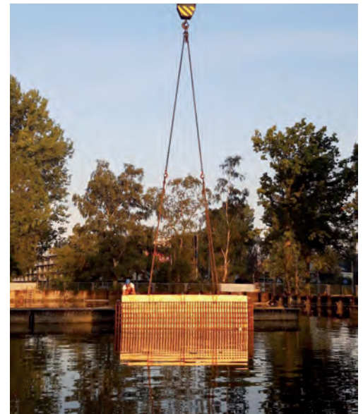
De wapening werd met een speciaal hijsframe op de juiste plaats onder water aangebracht. Op de foto wordt de prefab vloer van de liftput afgezonken.
